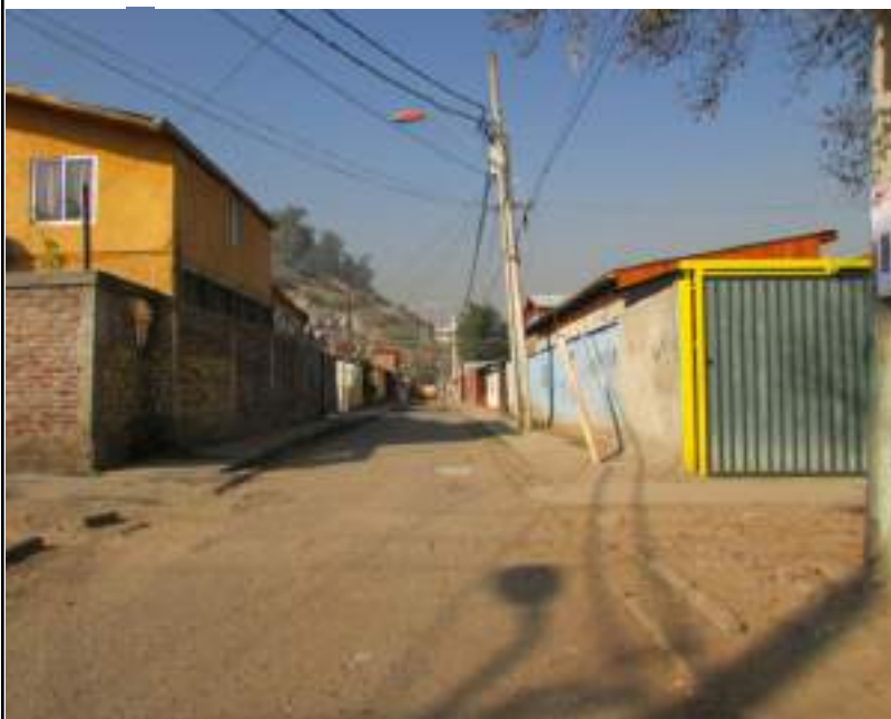
Foto 3 El deterioro de los Pavimentos locales de Huechuraba
